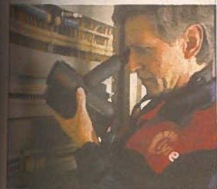
Harald Tjensvold fra Lyse kontrollerer sikringsskap.
