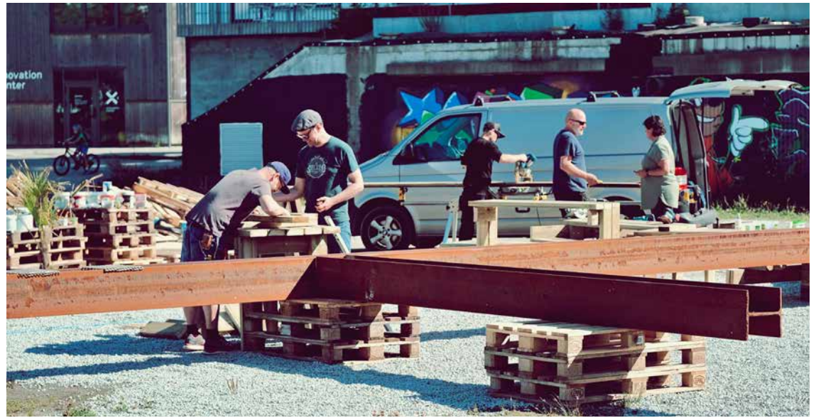
Bygging av en 15 meter lang grill på ventetomten ved Tou, et initiativ av Ketil Dybvig med støtte fra bl.a. Prosjekttil og Nordic Steel.
